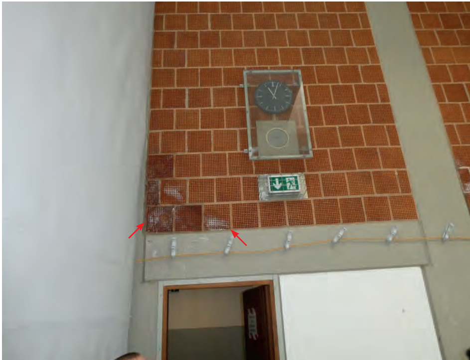
Foto 90: Sporthalle – südliches Hallendrittel Übersicht östlicher Wandabschnitt oberhalb Stahlbetonsturz mit hellen Verfärbungen auf Oberfläche Mauerwerk
