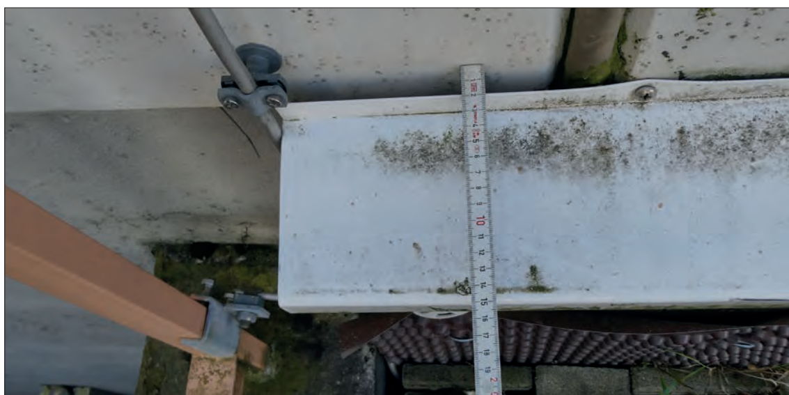
Abb. 5 Westlicher Abschnitt Nordostfassade – Abstand zwischen Aufkantung und Blechabdeckung (Foto von Unterzeichnern – 23.02.2024)
