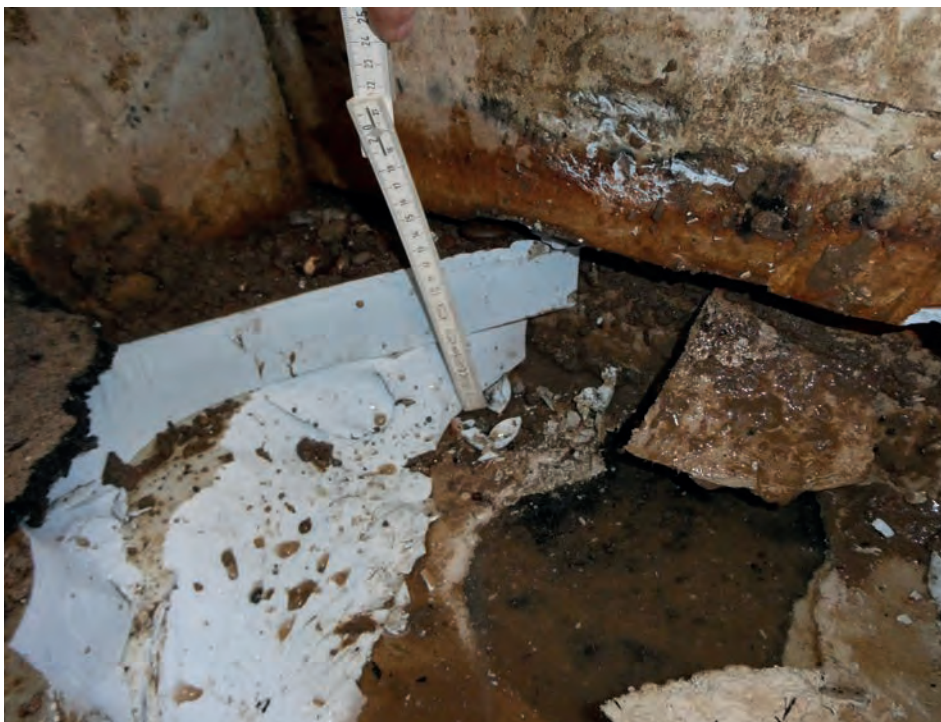
Foto 29: Sondageöffnung 01 – Süd Detailaufnahme Dämmschicht zweilagig Dämmmaterial punktuell entfernt Wasser auf Abdichtungsoberfläche vorhanden
