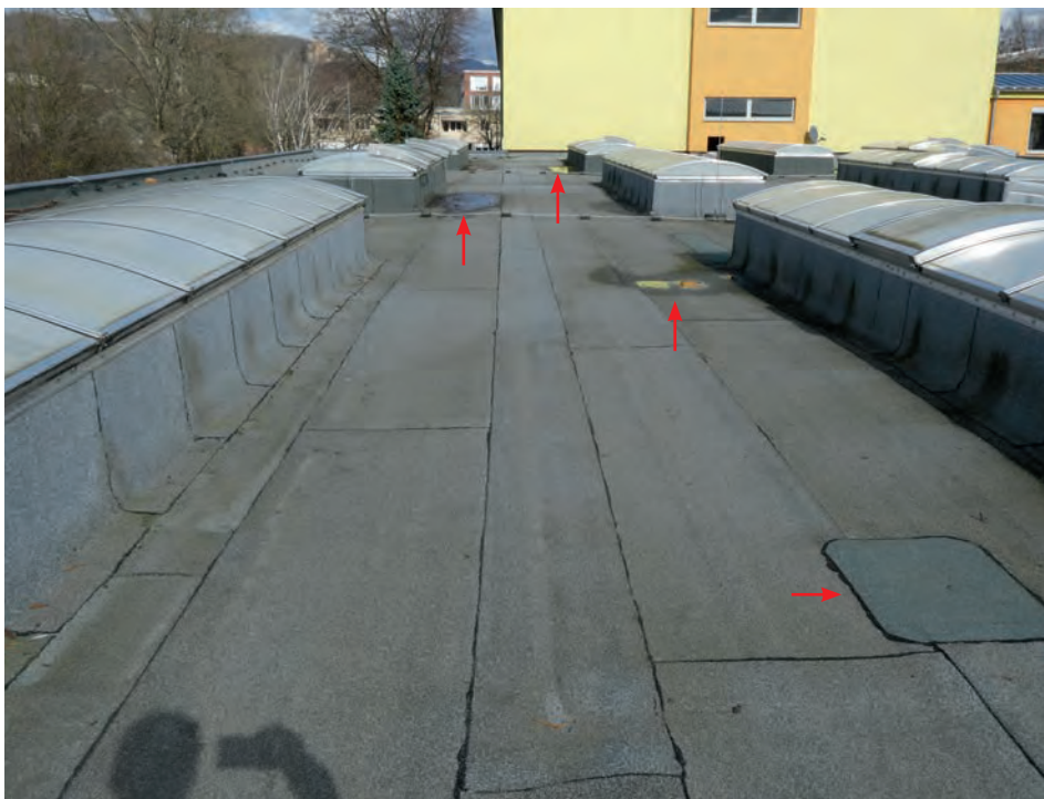
Foto 62: Sporthalle – Flachdach Übersicht Mehrere Pfützen am Fuße von Lichtbändern Verlegung zusätzlicher Abdichtungsbahnenabschnitt
