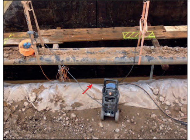
Abb. 21 Nordwestfassade – Wasser auf Arbeitsraumsohle
