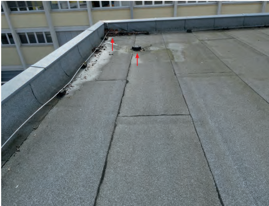
Foto 57: Sporthalle – Flachdach Übersicht Laubansammlung in Aufkantungsinnenecke Laub und organisches Material um Dachablauf
