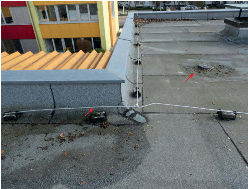
Foto 51: Sporthalle und Haustechnikraum – Flachdach Übersicht Blitzschutzleitung verläuft oberhalb Dachleitungshalter Laub und organisches Material um Dachablauf
