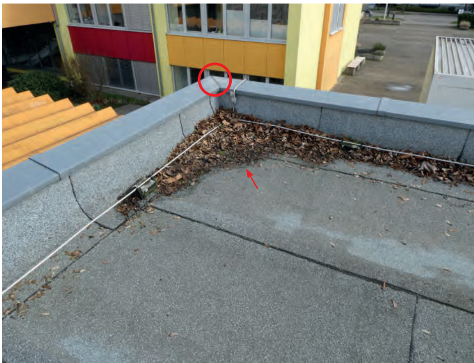
Foto 52: Haustechnikraum – Flachdach Übersicht und Detailaufnahme Flachdachfläche oberhalb Haustechnikraum mit Laubansammlung in Aufkantungsecke Foto rechts: Lötnaht an Blechabdeckungsstoß
