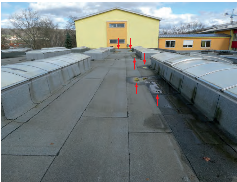
Foto 60: Sporthalle – Flachdach Übersicht östlicher Flachdachabschnitt im Hintergrund: südwestliche Giebelwand Kaufmännische Schule Lörrach mehrere Pfützen an Lichtbandaufkantungen
