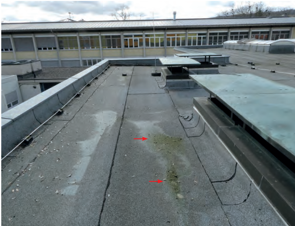
Foto 53: Sporthalle – Flachdach Übersicht Besiedlung von Mikroorganismen
