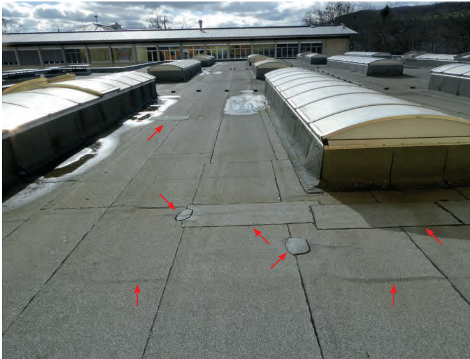
Foto 49: Sporthalle – Flachdach Übersicht Verlegung zusätzlicher Abdichtungsbahnenabschnitte Erhebungen/Falten in Dachdeckungsbahnen
