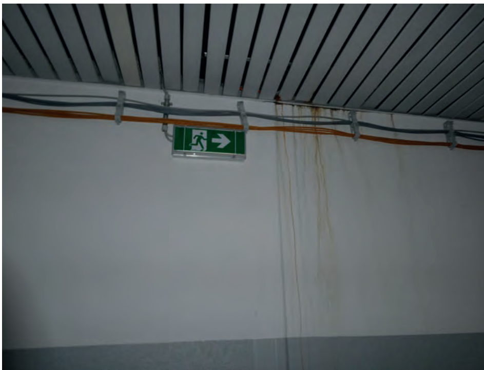
Foto 85: Innenbereich – Mittelflur Übersicht Streifenförmige dunkle Verfärbungen/Ablaufspuren auf östlicher Flurwandfläche unterhalb abgehängter Decke
