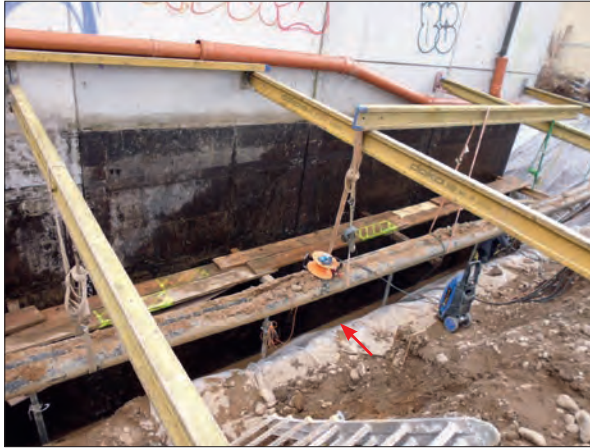
Abb. 20 Nordwestfassade – Wasser auf Arbeitsraumsohle
