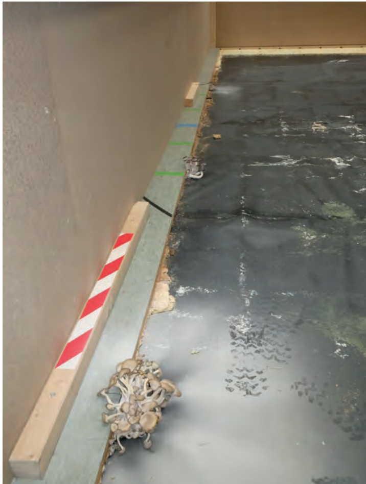
Foto 130: Sporthalle – nördliches Hallendrittel Übersicht und Detailaufnahme Pilzfruchtkörper Hallenboden hinter Absperrung
