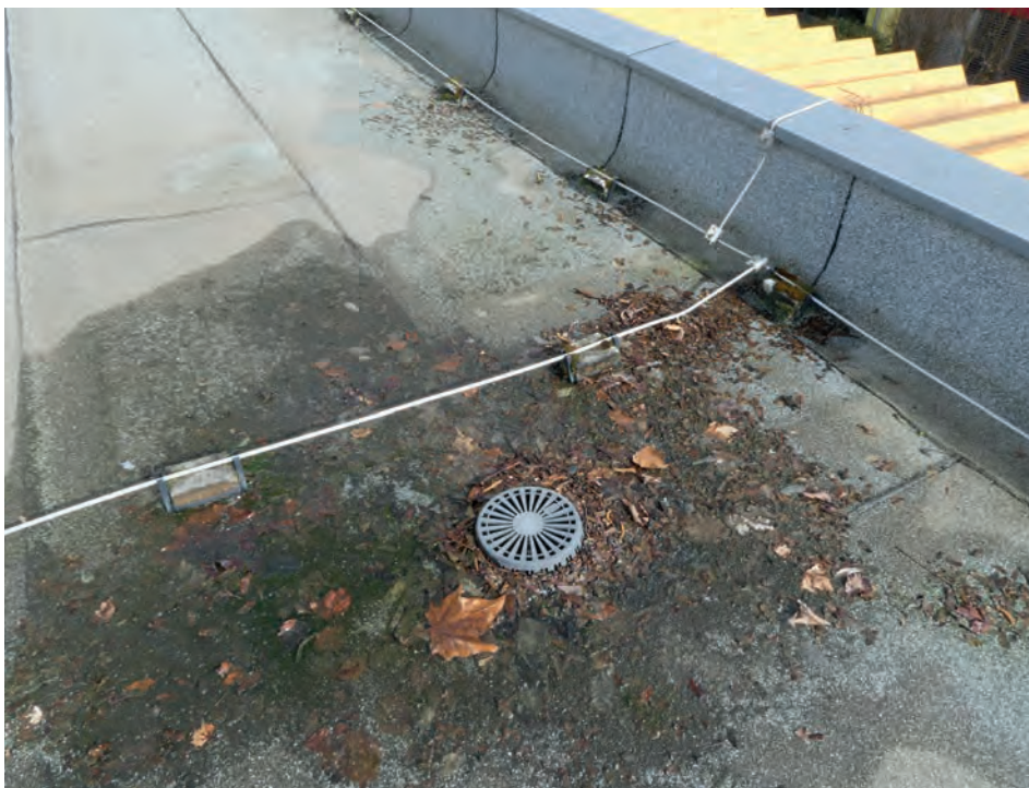
Foto 42: Sporthalle – Flachdach Übersicht Blitzschutzleitungen Laub und organisches Material um Dachablauf
