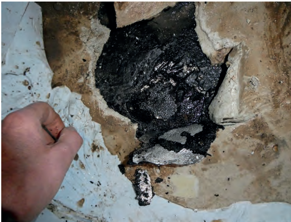
Foto 31: Sondageöffnung 01 – Süd Detailaufnahme Abdichtungsoberfläche nach Wasserabsaugung
