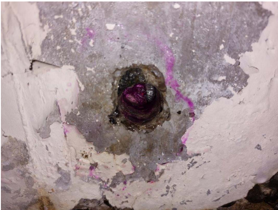
Foto A20: Untersuchungsstelle 21 – Karbonatisierungstiefe ca. 5 - 12 mm
