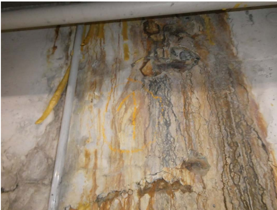
Foto 30: Untersuchungsstelle 1 – Wasserzutritt, Ausblühungen und Korrosionsschäden
