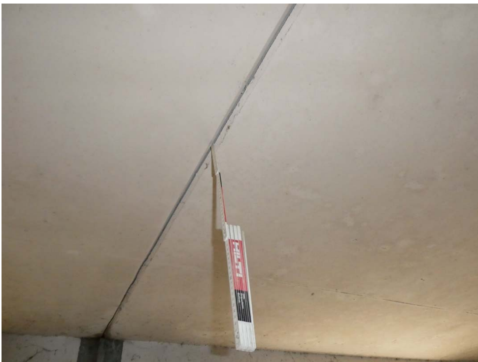
Foto 14: Untere Parkebene – unten offene Elementplattenfuge der Decke
