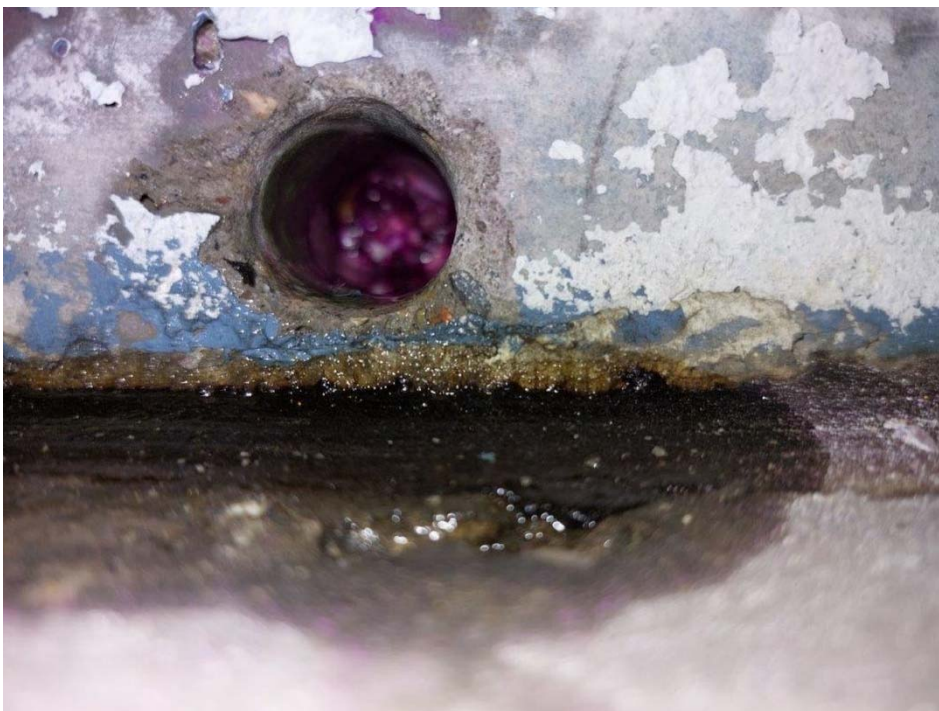
Foto A16: Untersuchungsstelle 14 – Karbonatisierungstiefe ca. 20 mm
