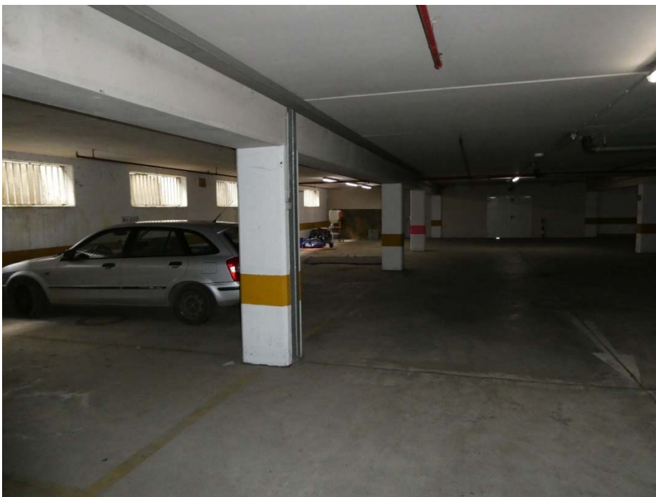
Foto 12: Untere Parkebene – Bodenplatte unbeschichtet, Stützen + Wände + Decke mit Anstrich
