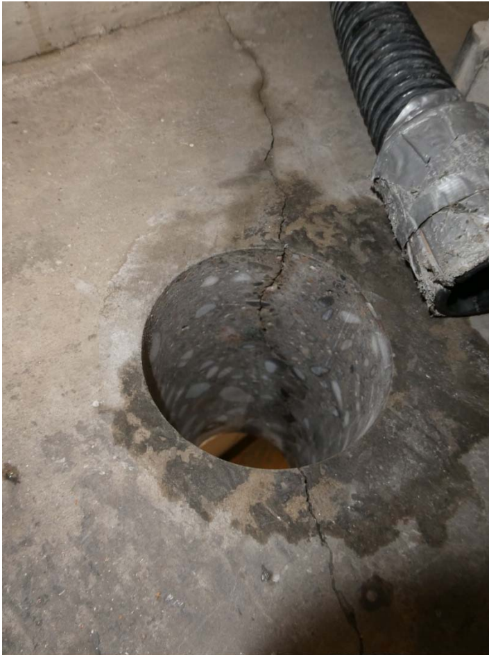
Foto 25: Obere Parkebene – Durchgängiger Trennriss durch Zwischendecke
