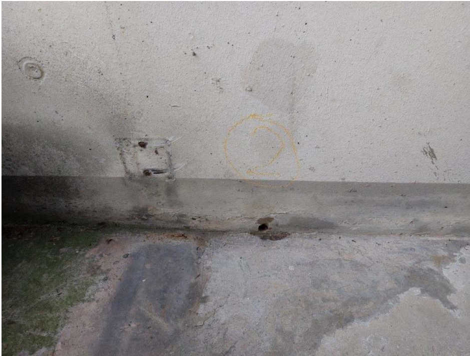
Foto A1: Untersuchungsstelle 2 – Treppenhauswand obere Parkebene
