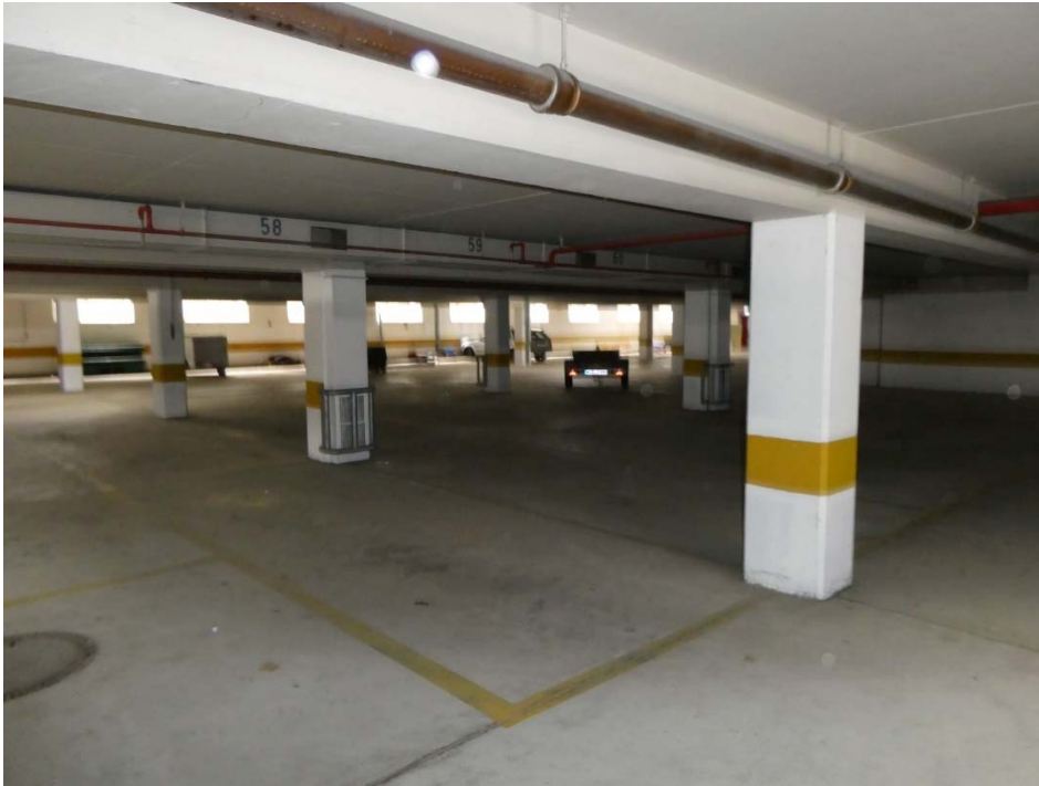
Foto 11: Untere Parkebene – Bodenplatte unbeschichtet, Stützen + Wände + Decke mit Anstrich
