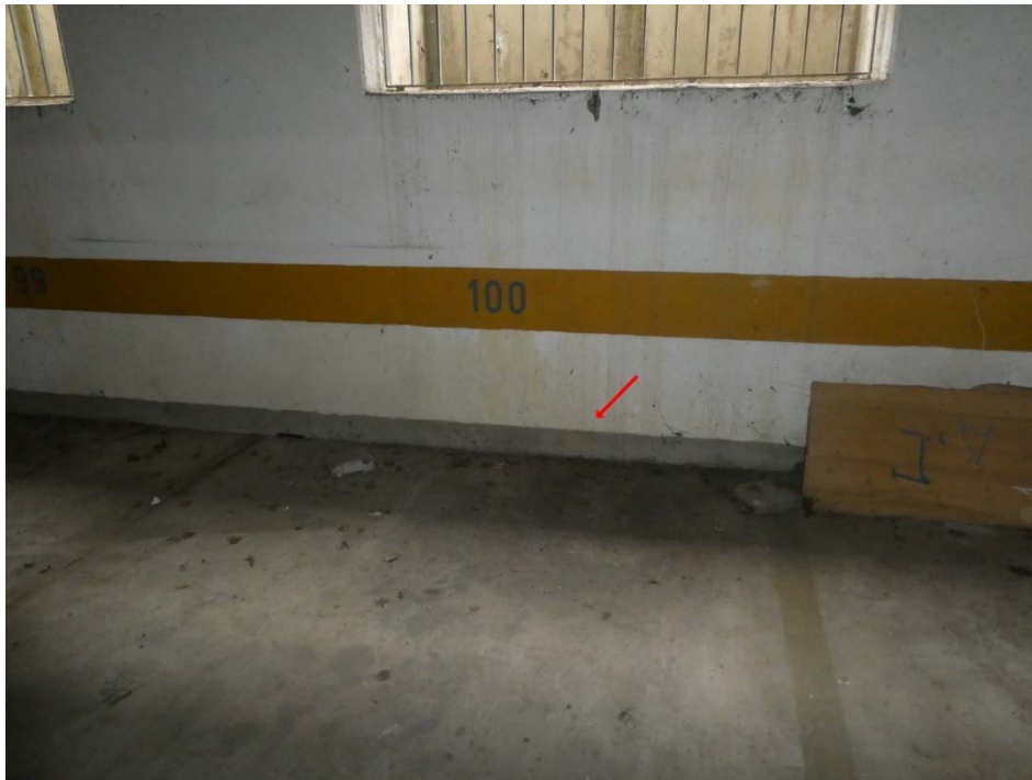
Foto 63: Untersuchungsstelle 19 – Außenwandsockel untere Parkebene
