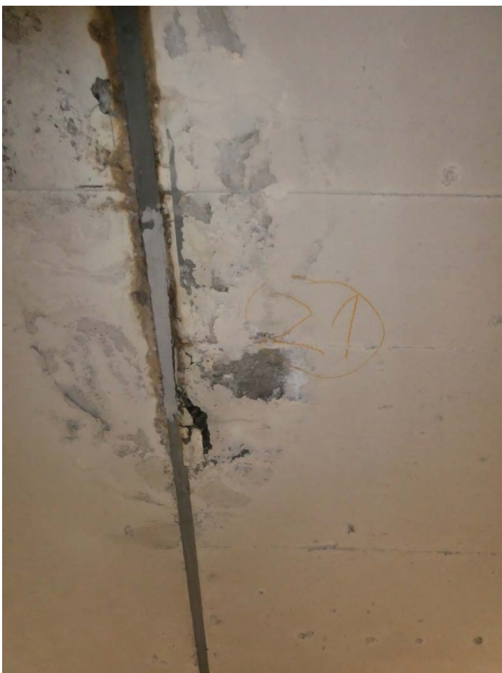
Foto 68: Untersuchungsstelle 21 – Decke Bereich neben schadhafter Dehnfuge mit Ausblühungen
