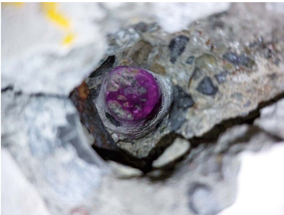
Foto A14: Untersuchungstelle 13 – Karbonatisierungstiefe im Riss ca. 35 - 50 mm
