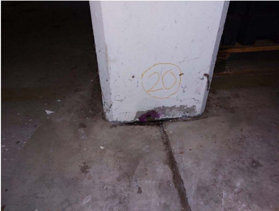
Foto A17: Untersuchungsstelle 20 – Stützensockel untere Parkebene
