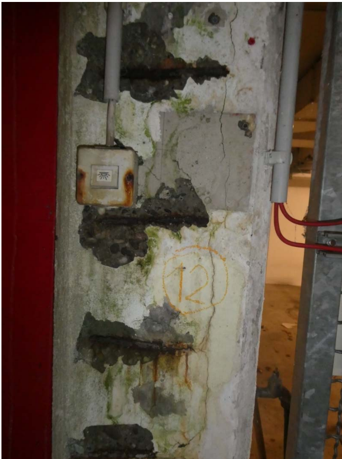
Foto 52: Untersuchungsstelle 12 – Ausblühungen, Abplatzungen und Korrosionsschäden
