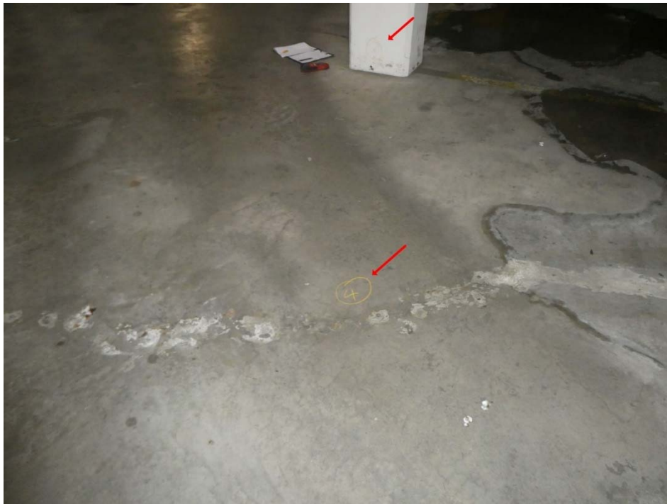
Foto 33: Untersuchungsstelle 3 + 4 – Stützensockel und Bodenfläche obere Parkebene
