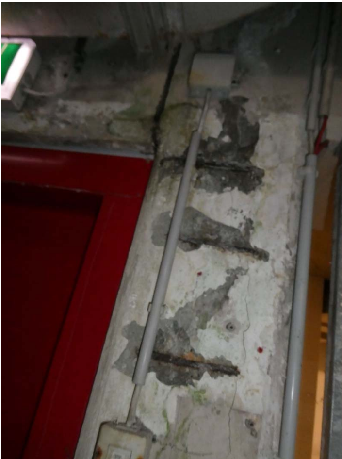
Foto 18: Untere Parkebene – Wand Aussentreppenhaus, freiliegende korrodierte Bewehrung
