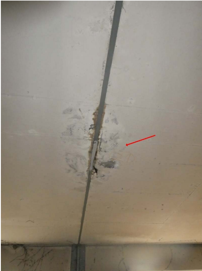
Foto 67: Untersuchungsstelle 21 – Decke obere Parkebene
