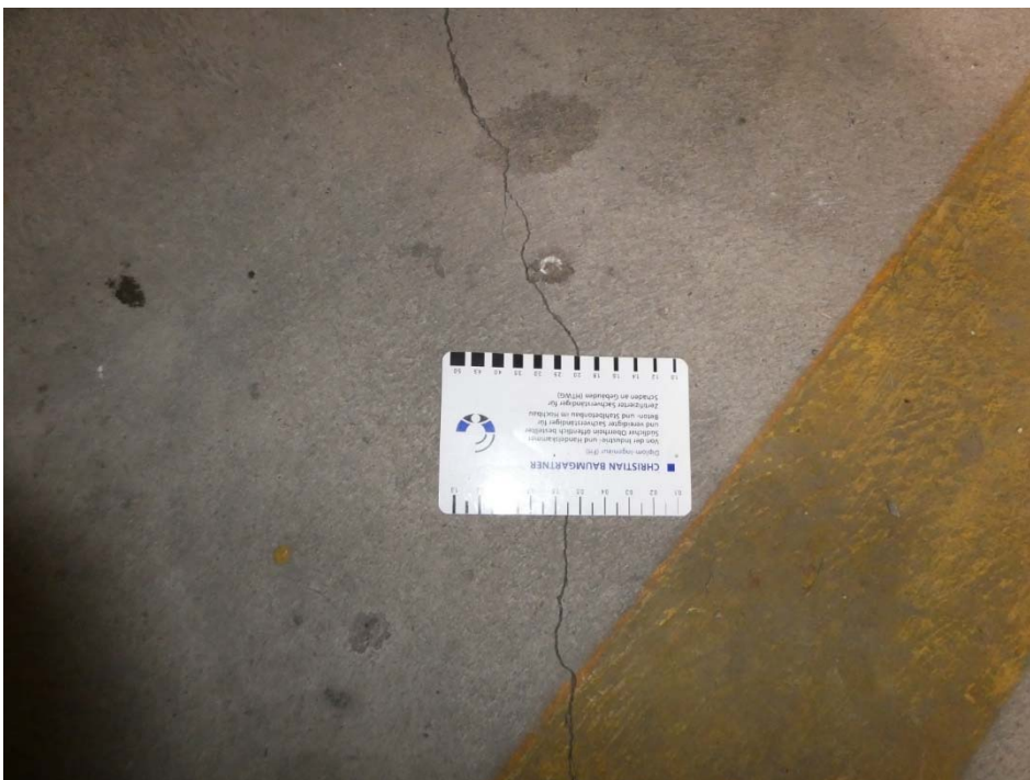
Foto 22: Obere Parkebene – Bohrkernentnahme im Bereich Trennriss Breite ca. 0,55 mm
