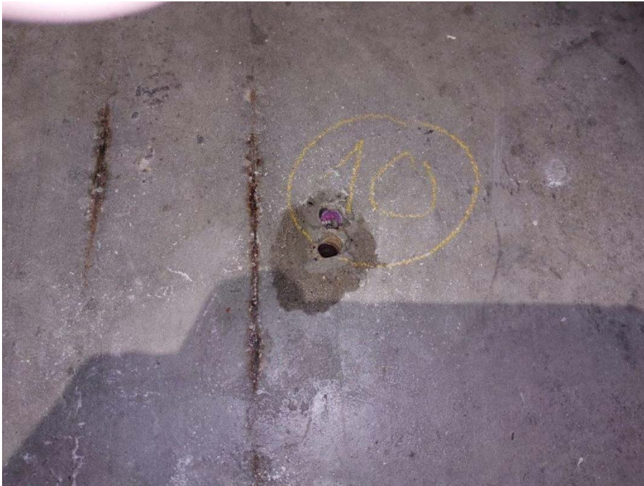
Foto A11: Untersuchungsstelle 10 – Bodenfläche Abfahrtsrampe zur unteren Parkebene
