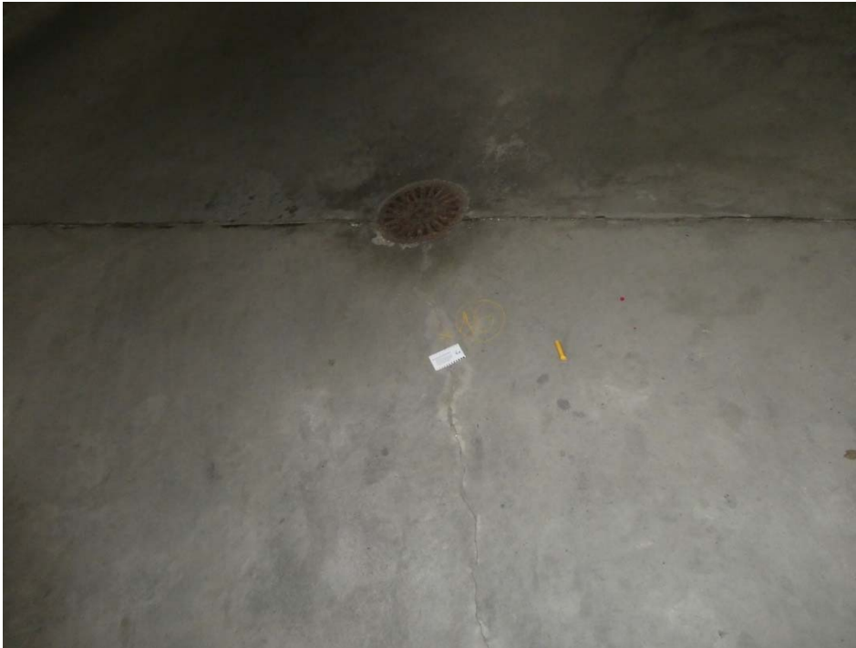
Foto 57: Untersuchungsstelle 16 – Bodenfläche neben Bodeneinlauf untere Parkebene
