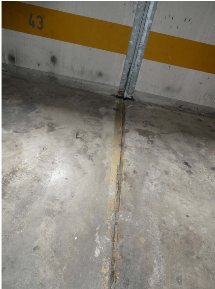
Foto 5: Obere Parkebene – Bauwerksdehnfuge, schadhafte Fugenverfüllung Bodenfuge
