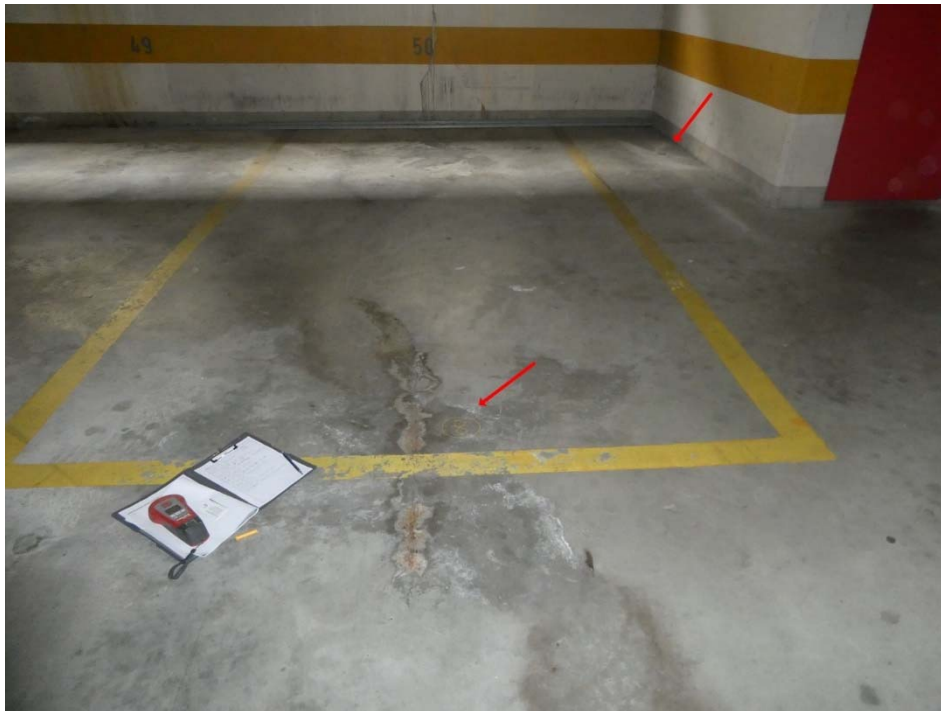
Foto 43: Untersuchungsstelle 8 – Bodenfläche obere Parkebene neben Bohrkern
