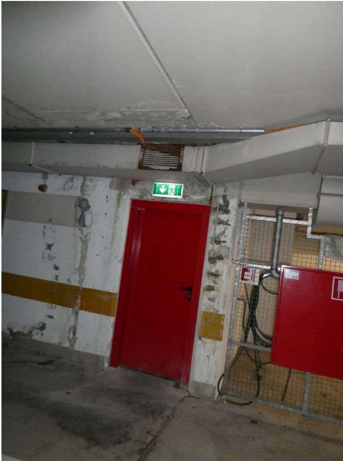
Foto 17: Untere Parkebene – Wand Aussentreppenhaus, Ausblühungen, Betonschäden
