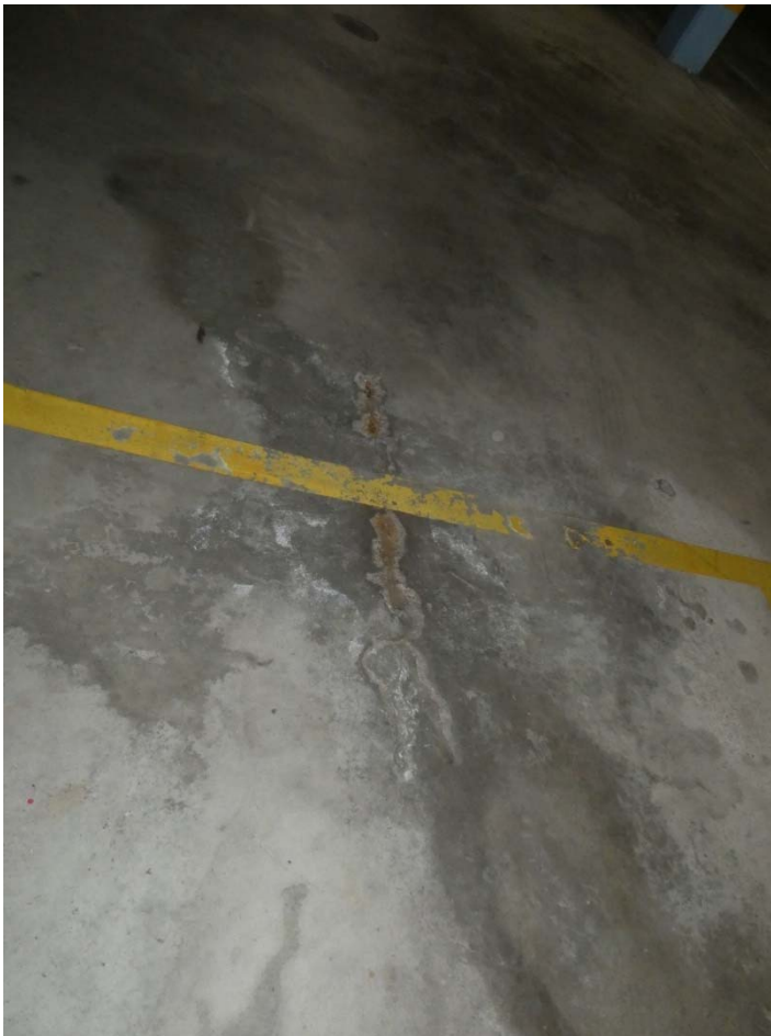
Foto 2: Obere Parkebene – Abplatzungen, freiliegende korrodierte Bewehrung, Reparaturstellen
