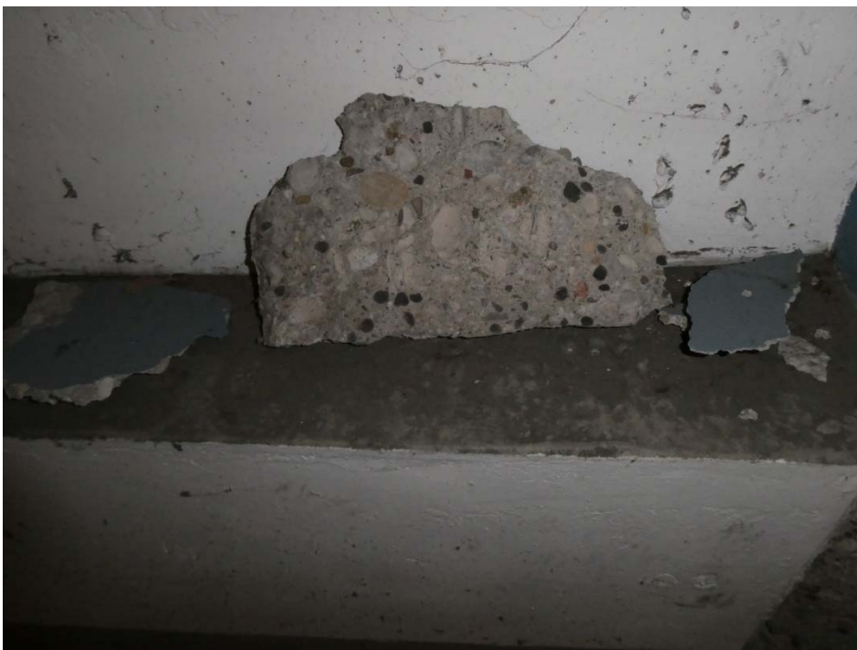
Foto 10: Innenliegende Rampe – Betonabplatzung im Wandsockelbereich
