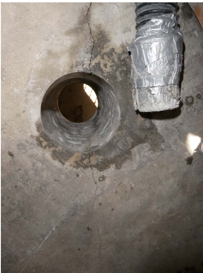
Foto 26: Obere Parkebene – Durchgängiger Trennriss durch Zwischendecke
