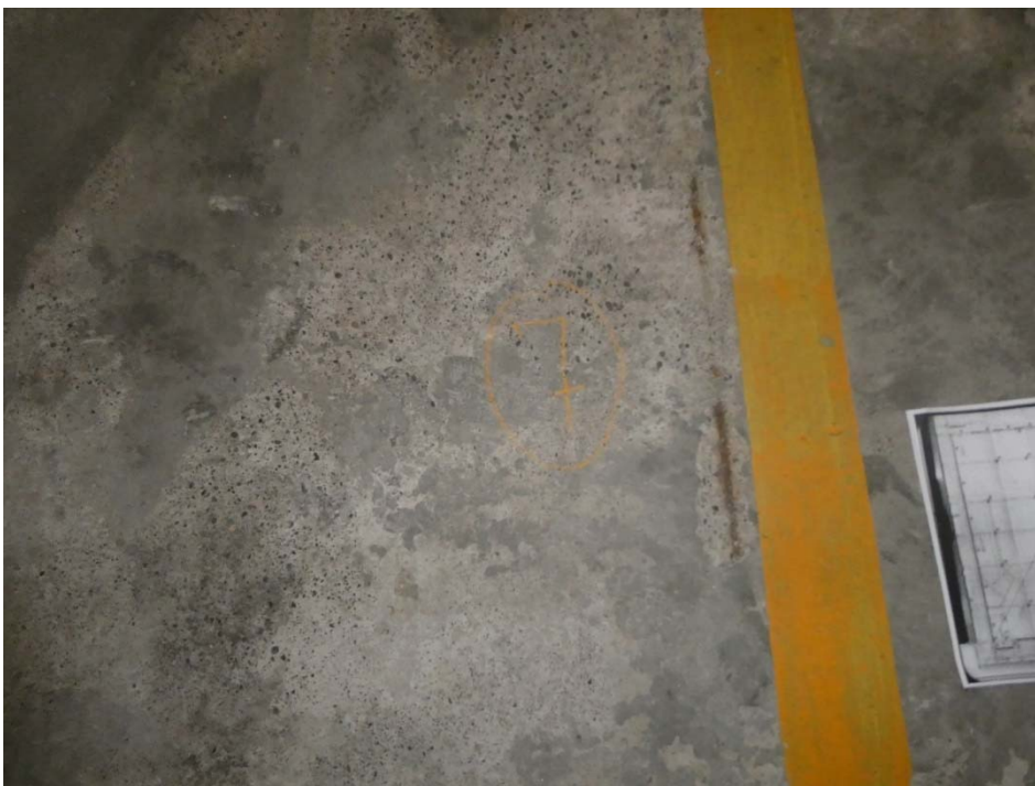
Foto 42: Untersuchungsstelle 7 – Bodenfläche Bereich freiliegender korrodierter Bewehrung
