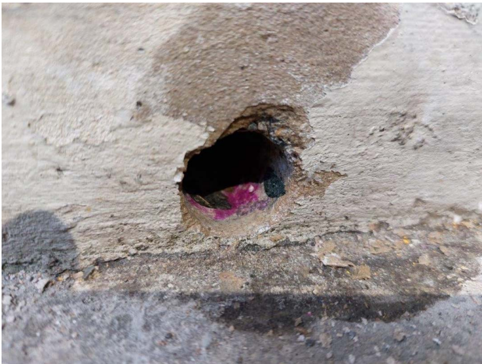
Foto A2: Untersuchungsstelle 2 – Karbonatisierungstiefe ca. 20 mm
