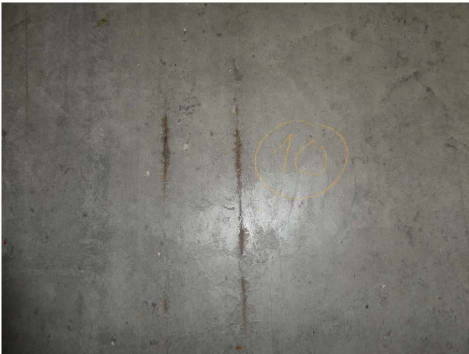
Foto 48: Untersuchungsstelle 10 – Bodenfläche Bereich freiliegender korrodierter Bewehrung
