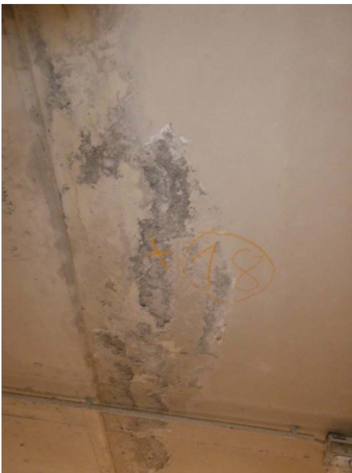
Foto 62: Untersuchungsstelle 18 – Decke Bereich neben Elementplattenfuge mit Ausblühungen
