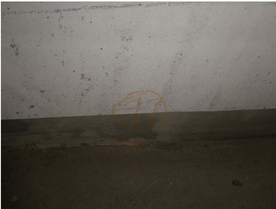
Foto 50: Untersuchungsstelle 11 – Wandsockel mit Farbablösungen
