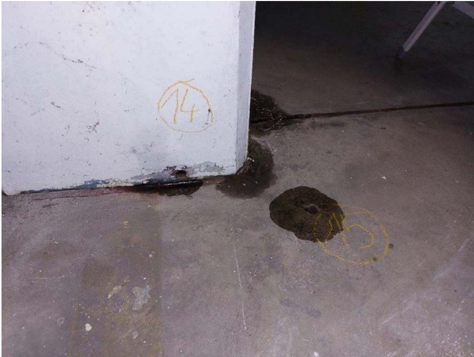
Foto A15: Untersuchungsstelle 14 – Stützensockel untere Parkebene
