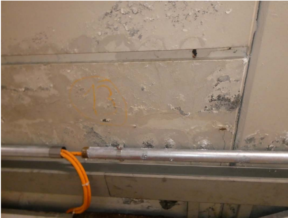
Foto 53: Untersuchungsstelle 13 – Decke unteren Parkebene vor Treppenhaus
