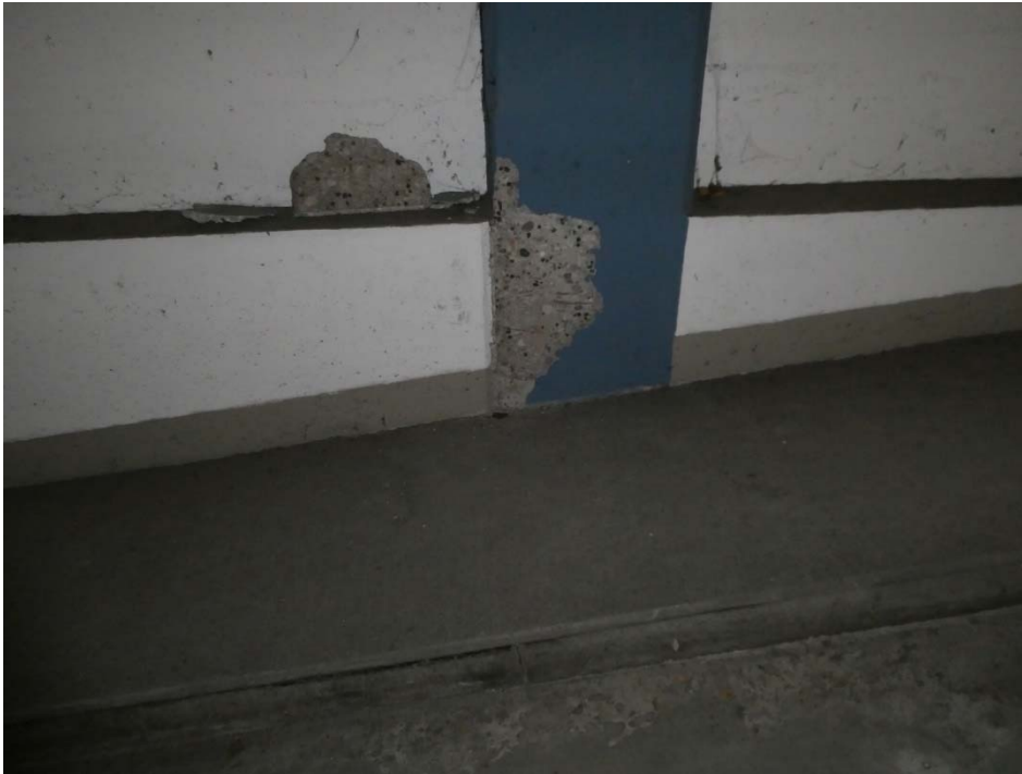
Foto 9: Innenliegende Rampe – Betonabplatzung im Wandsockelbereich
