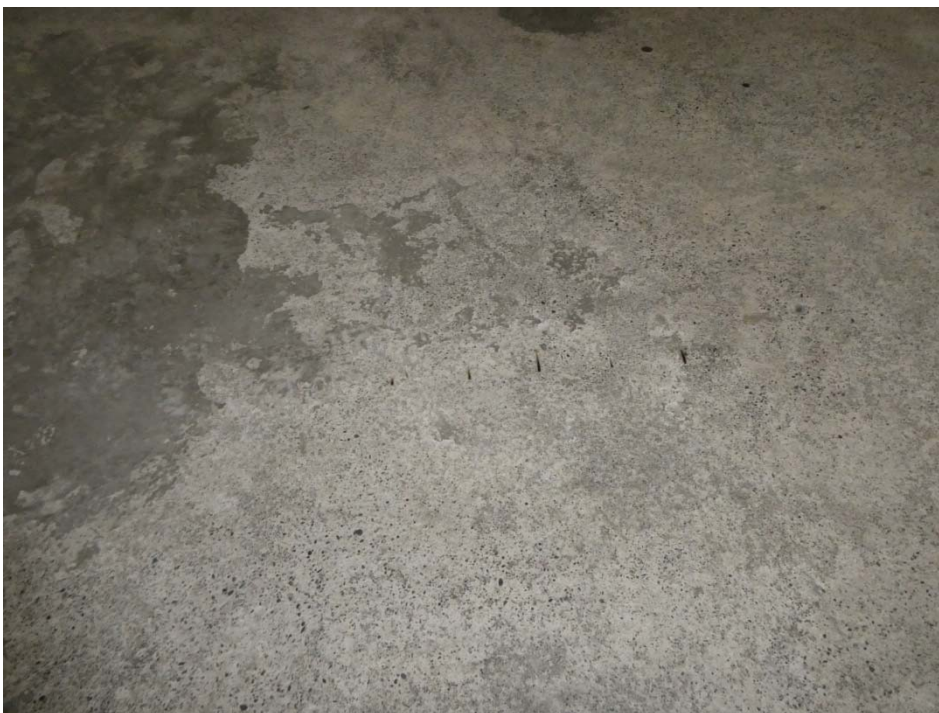
Foto 4: Obere Parkebene – Abrieb, Betonoberfläche, freiliegende korrodierte Bewehrung
