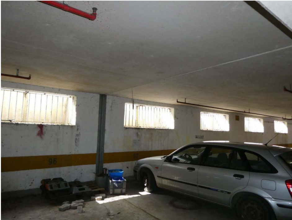
Foto 13: Untere Parkebene – Farbablösungen und Verschmutzungen an Außenwand
