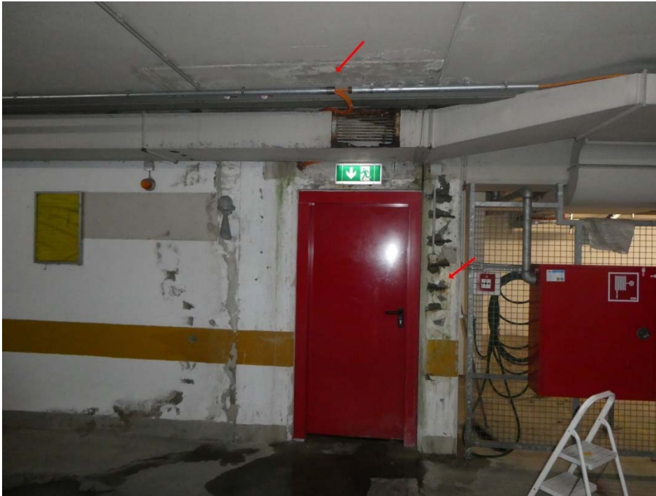
Foto 51: Untersuchungsstelle 12 – Treppenhauswand unteren Parkebene
