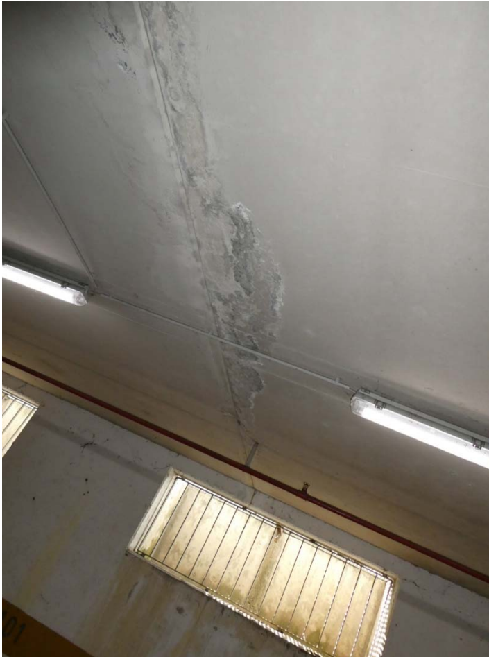
Foto 15: Untere Parkebene – Ausblühungen entlang Elementplattenfugen
