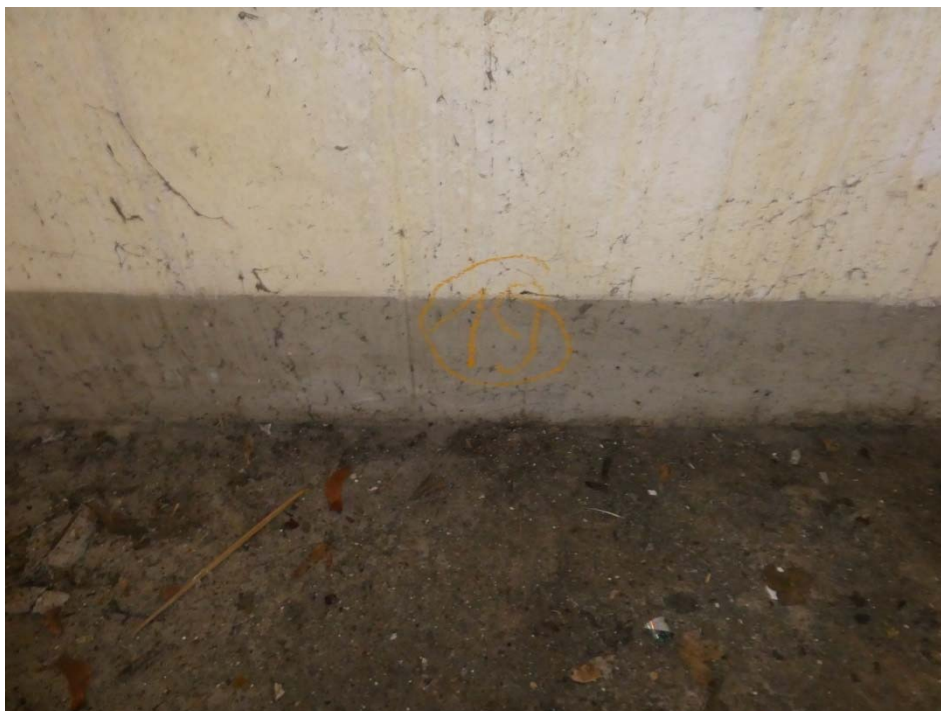
Foto 64: Untersuchungsstelle 19 – Außenwandsockel im Pfützenbereich
