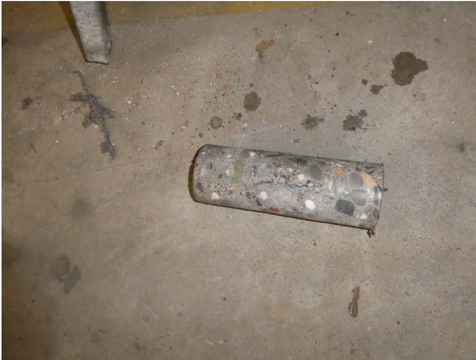
Foto 27: Obere Parkebene – Bohrkern, kein Zementglattstrich an Deckenoberfläche
