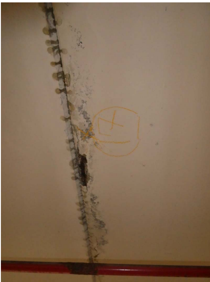
Foto 60: Untersuchungsstelle 17 – Decke Bereich neben Element- plattenfuge mit Ausblühungen
