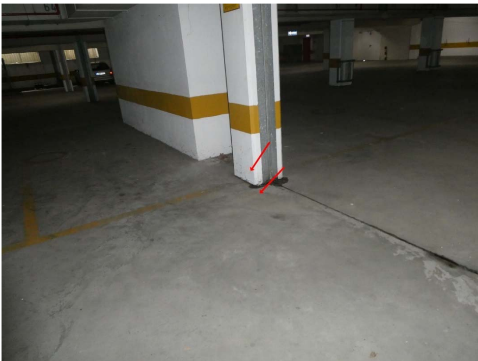
Foto 54: Untersuchungsstelle 14 + 15 – Stützensockel und Bodenfläche untere Parkebene
