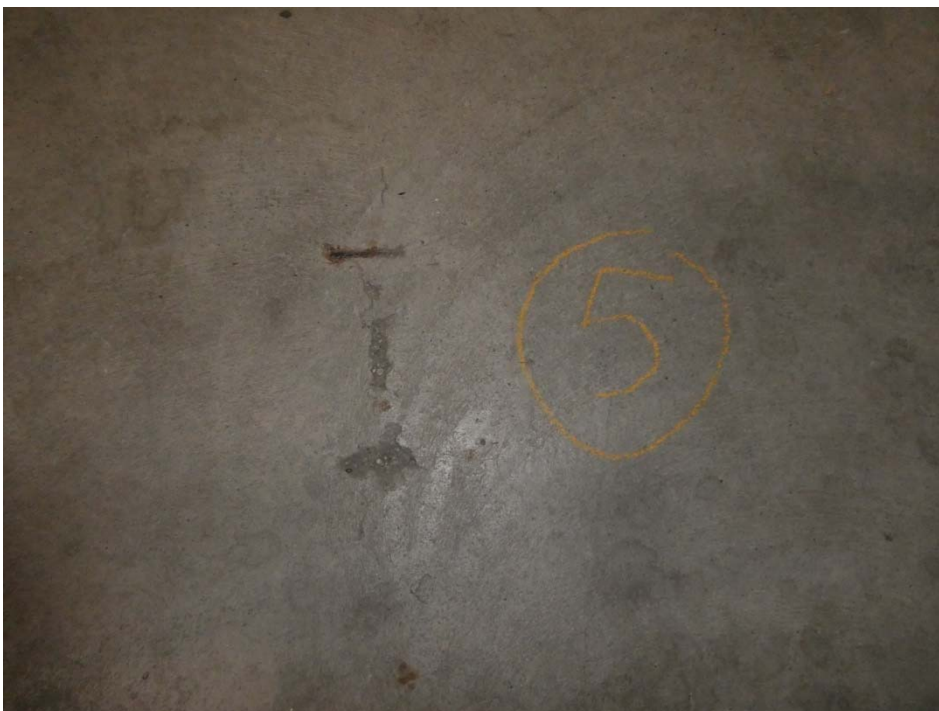
Foto 38: Untersuchungsstelle 5 – Bodenfläche Bereich freiliegender korrodierter Bewehrung
