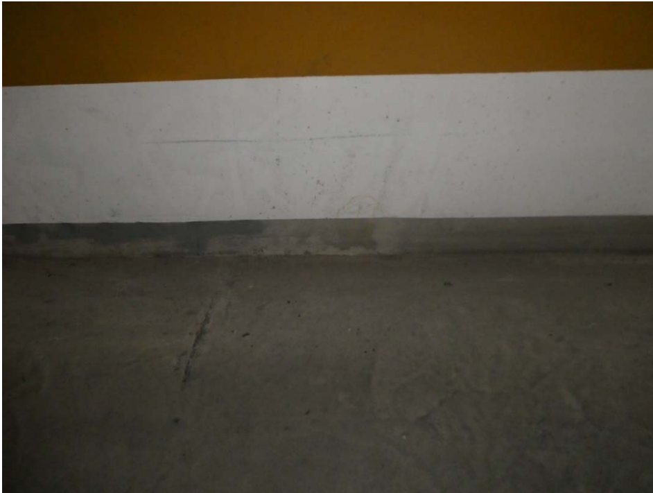
Foto 49: Untersuchungsstelle 11 – Wandsockel Abfahrtsrampe zur unteren Parkebene
