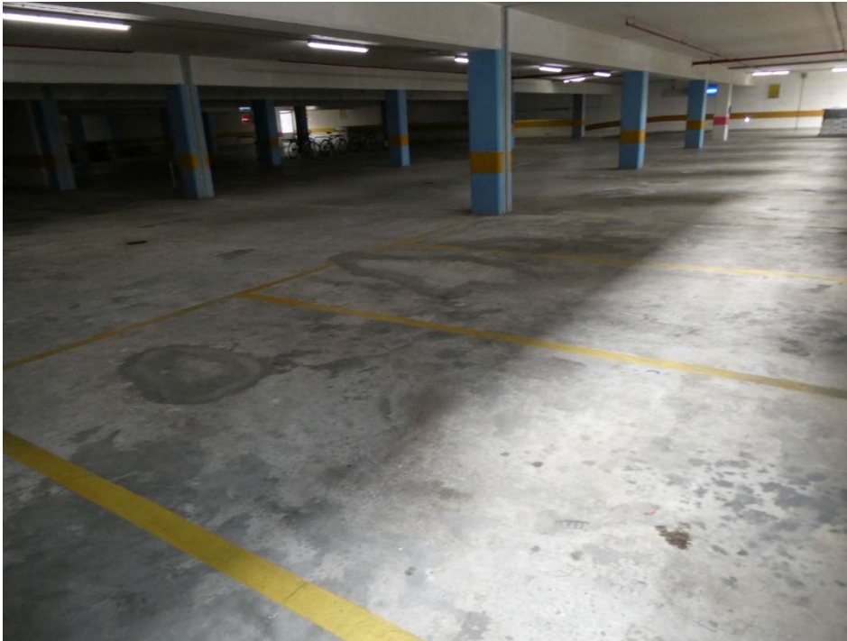
Foto 1: Obere Parkebene – Bodenplatte unbeschichtet, Stützen + Wände + Decke mit Anstrich
