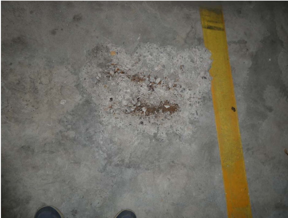
Foto 7: Obere Parkebene – Großflächige Abplatzungen, freiliegende korrodierte Bewehrung
