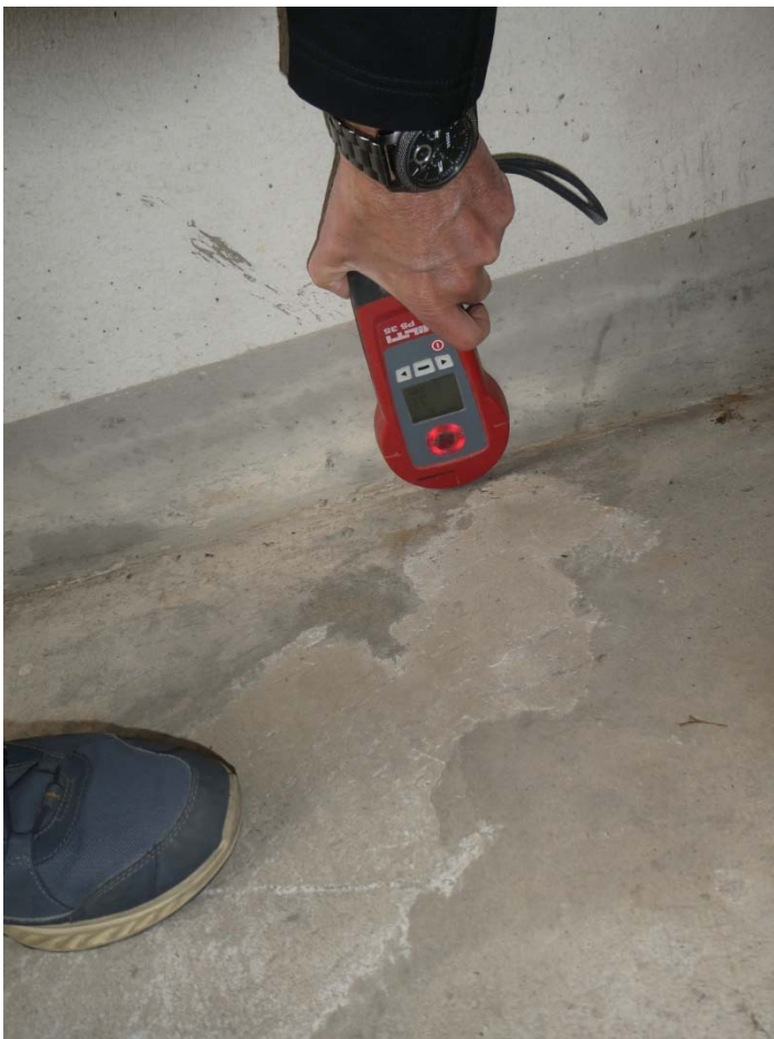
Foto 32: Untersuchungsstelle 2 – Wandsockel mit Farbablösungen, Ermittlung der Betonüberdeckung
