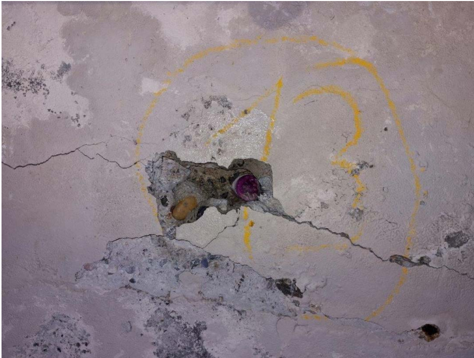
Foto A13: Untersuchungstelle 13 – Decke untere Parkebene
