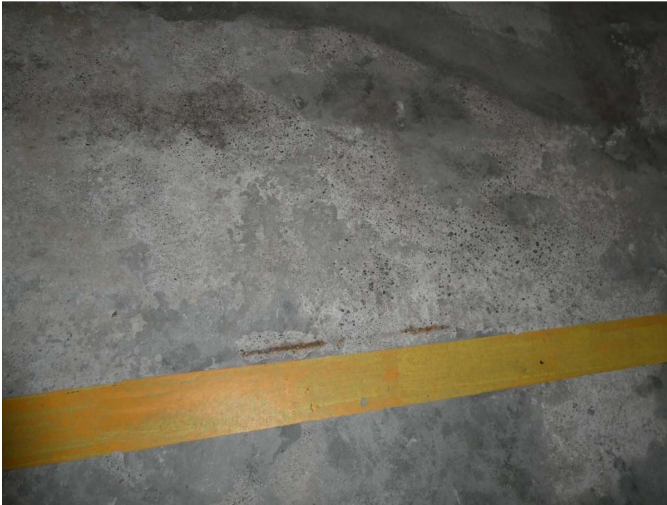
Foto 3: Obere Parkebene – Abrieb, Betonoberfläche, freiliegende korrodierte Bewehrung
