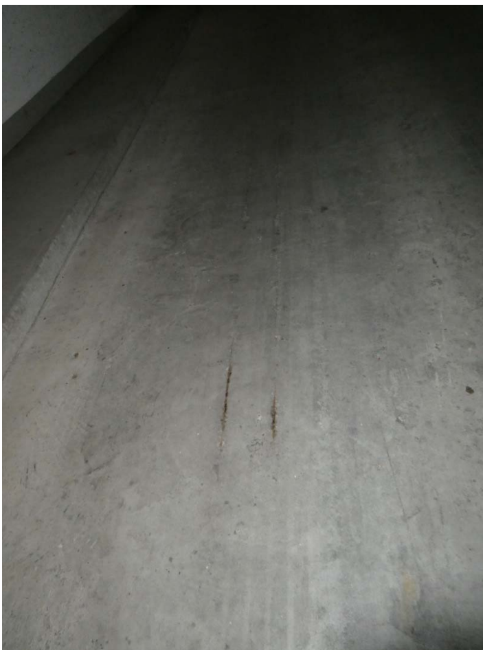
Foto 8: Innenliegende Rampe – freiliegende korrodierte Bewehrung
