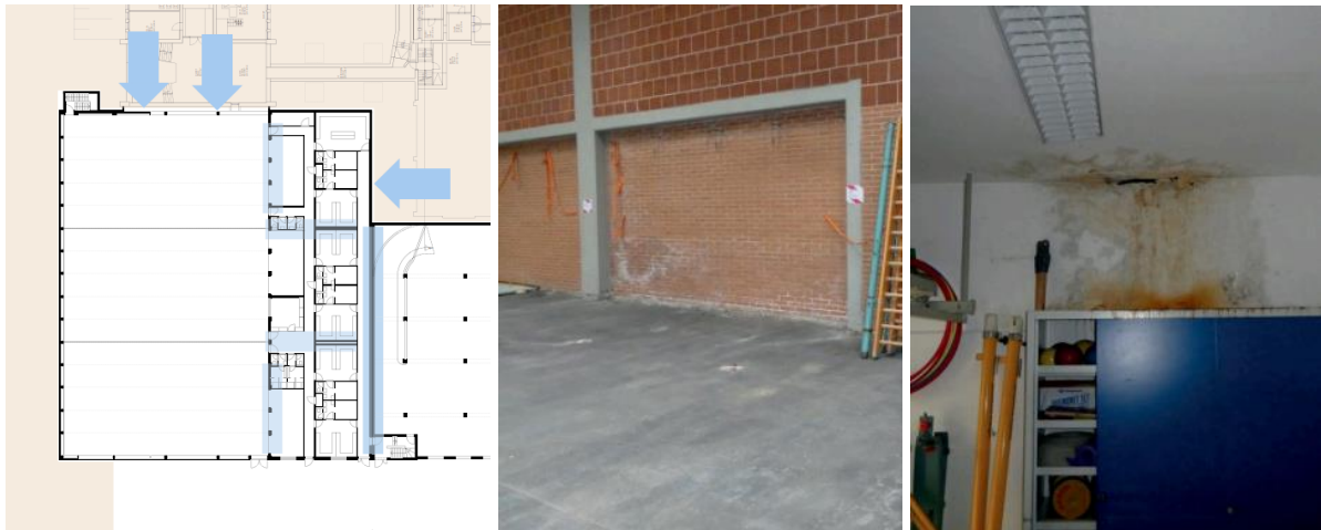
Wassereintritte in das Gebäude
